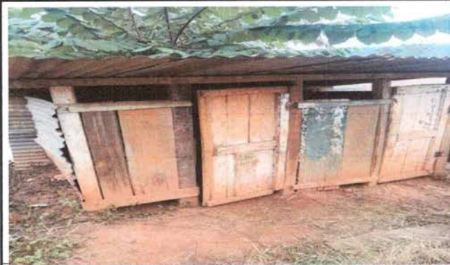
Foto 2: Se observa las letrinas que están forradas con laminas viejas y madera vieja.
